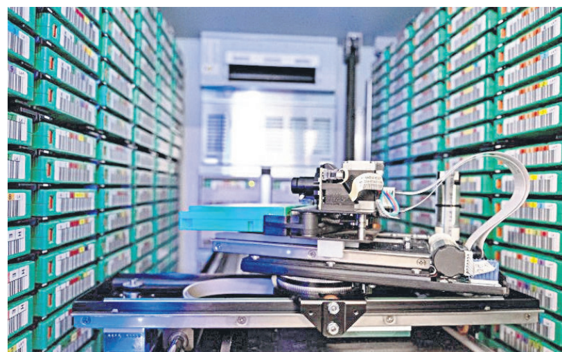
Infraestructura de almacenamiento del Centro de Supercomputación de Galicia.
